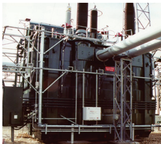
Slika 9: Postavljen fiber optički sistem na transformatoru [1]
