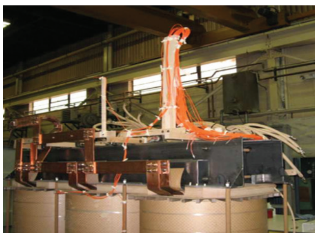
Slika 8: Postavljeni fiber optički senzori na transformatoru [3]
