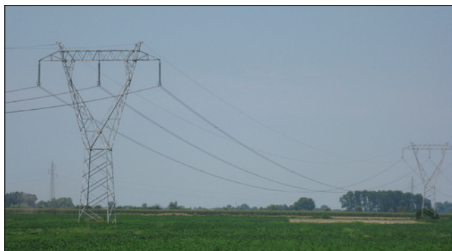
Slika 1: Nadzemni vod naponskog nivoa 400 kV
