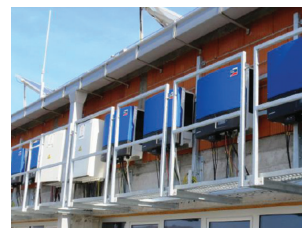
Slika 16.b: Fotonaponski generator – invertori
