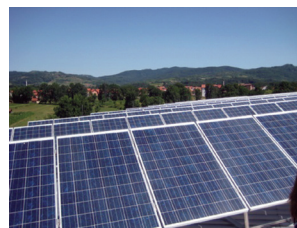
Slika 16.a: Fotonaponski generator – paneli na krovu
