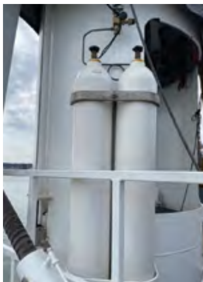
Rys. 6 Bateria butli awaryjnych na płaszczu dzwonu
